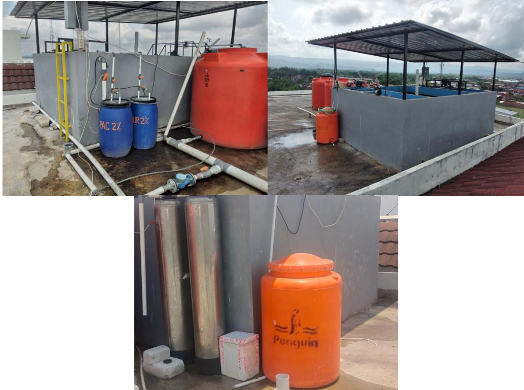
Model/Teknologi Pengolahan Air Kadar Zat Besi (Fe) Tinggi Gedung Lab dan Perkantoran BBTKLPP Yogyakarta
